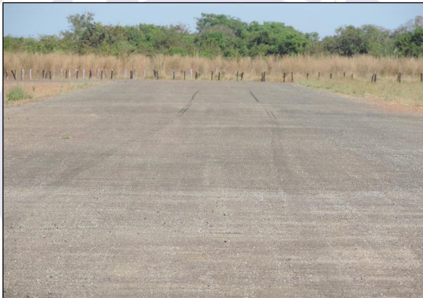
Figura 2 - Marcas de frenagem na pista (vista contrária ao sentido de pouso).
