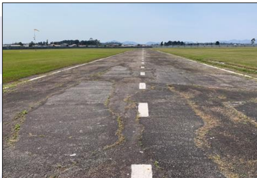
Figura 4 - Visão geral da pista, com pontos degradados e presença de vegetação.
