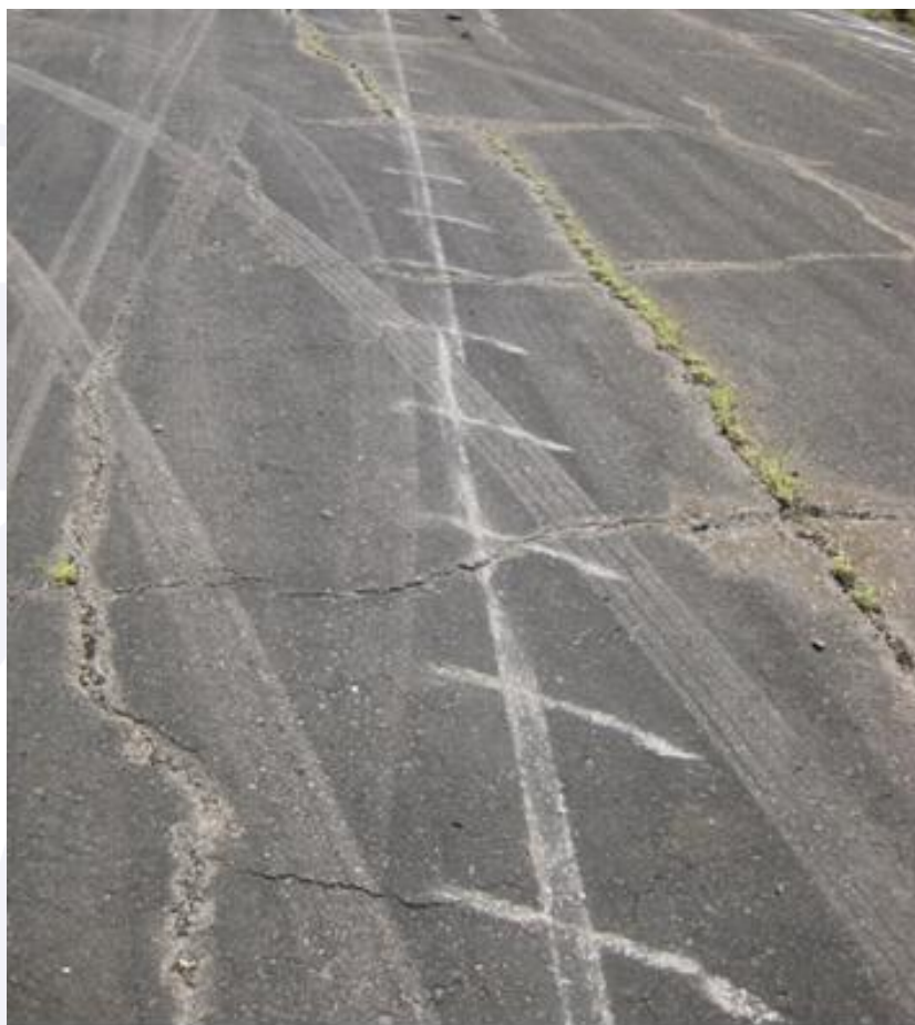
Figura 1 - Ranhuras, sem muita profundidade, em uma das laterais da pista, bem como marcas do contato da hélice com o solo.
